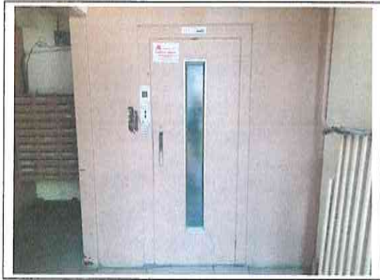
lift az épületben
