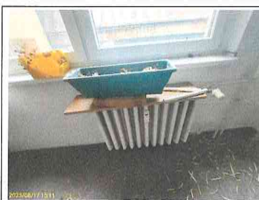
iroda hőleadó és nyílászáró
